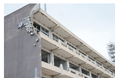
⑪ 壊れた壁
